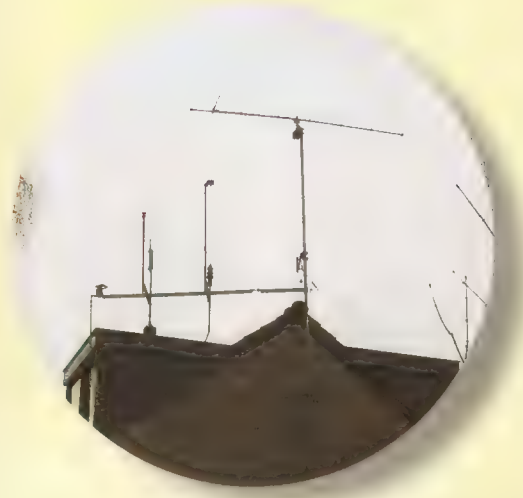
Diverse antennes dichtbij elkaar in Hoogland bij Amersfoort.
